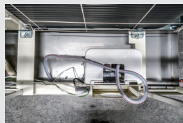
▲ 排水処理装置
