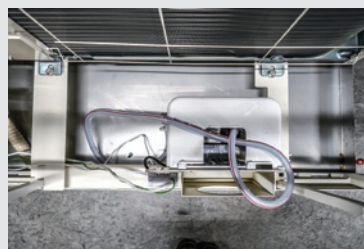
▲ 排水処理装置
